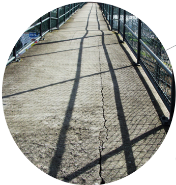
Pavimentos em mau estado de conservação e com uma materialidade desadequada
