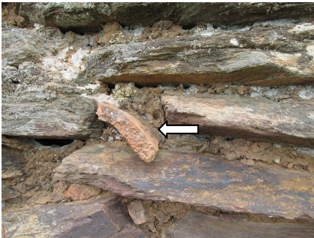
Imagem nº 24 – Nas paredes da segunda fase do alcácer encontramos cacos de cerâmica/ telha como enchimento ou nivelamento do aparelho usado neste período. Carlos Esquetim, 2016.
