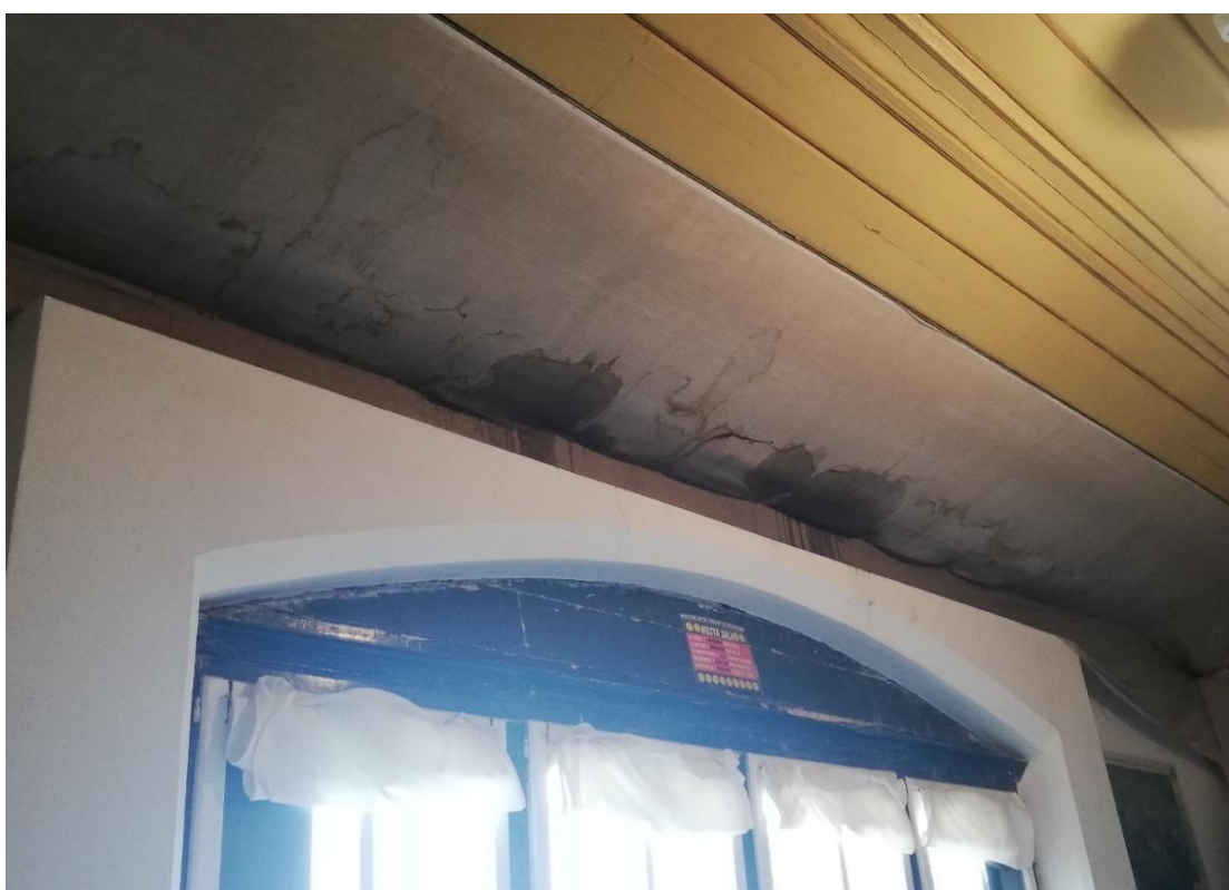
Imagem 9 - Fotografia do teto do gabinete na Quinta da Trindade no dia da inundação.
