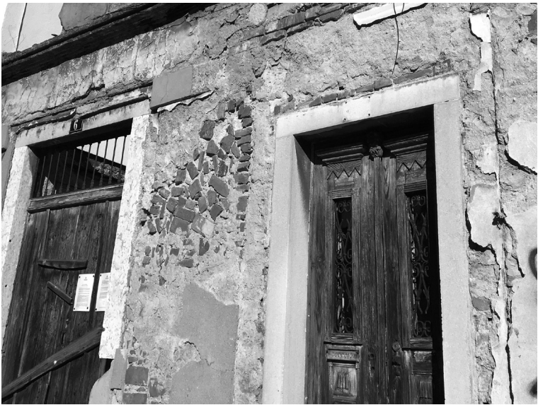
Img 68 | Ruína, Largo do Cabeço de Bola
