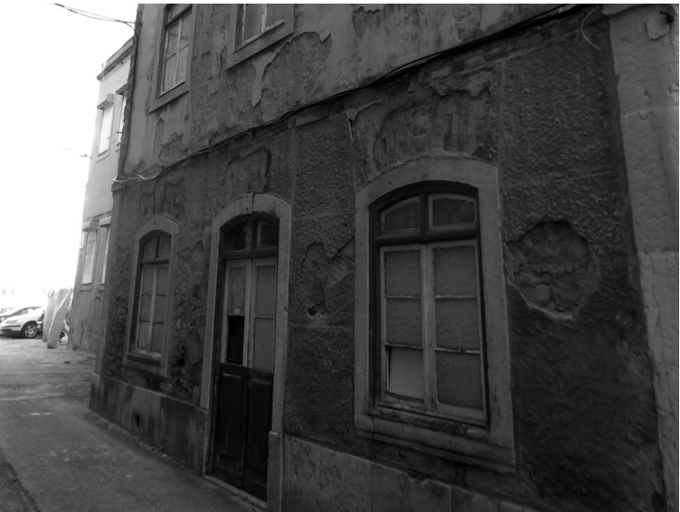
IMG 77 | EDIFÍCIO DEVOLUTO, RUA DAS BARRACAS
