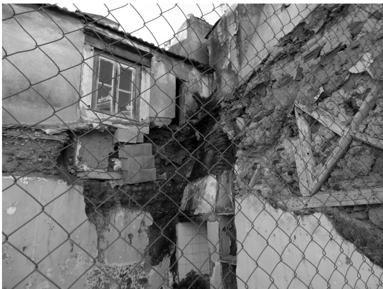
Img 66 | Degradação, Largo do Cabeço de Bola
