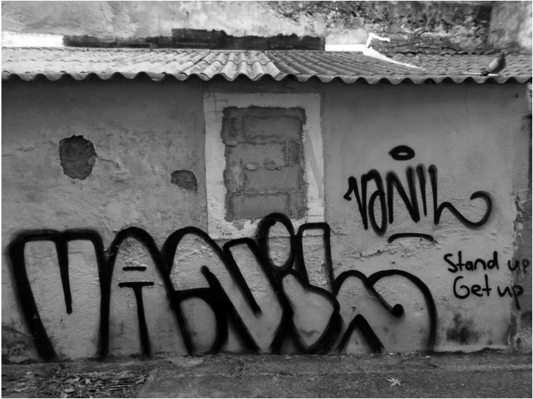
IMG 51 | EDIFÍCIO DEVOLUTO, RUA DAS BARRACAS
